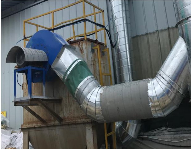
布袋除尘器（PVC 破碎、磨粉配料混料）
