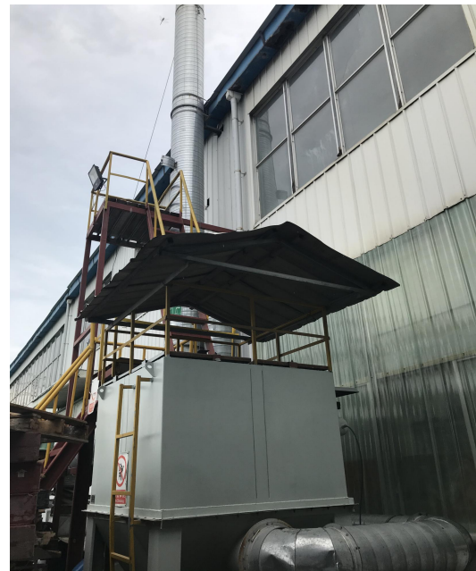
布袋除尘器（PE 破碎）
